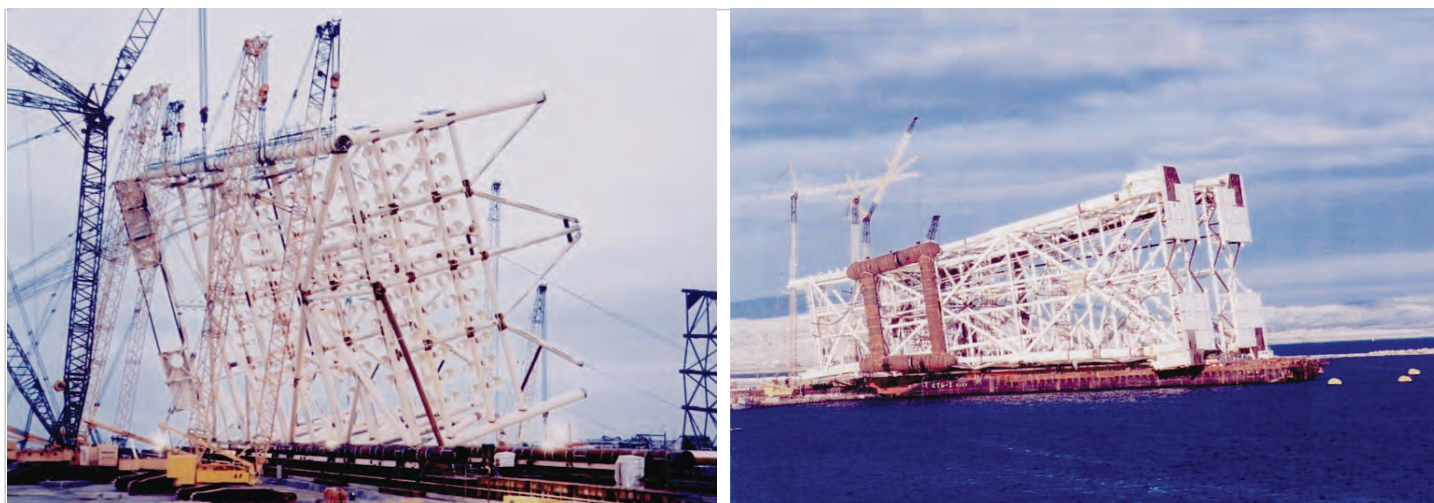
Опорные блоки основания установленного в центральной части месторождения «Азери».
