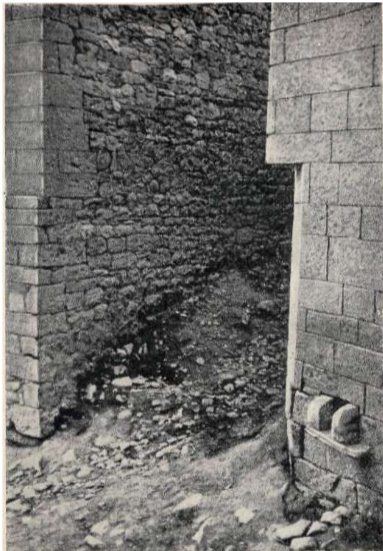
Срез угла дома и водослив в стене Сел. Уичугатль Лапского района
